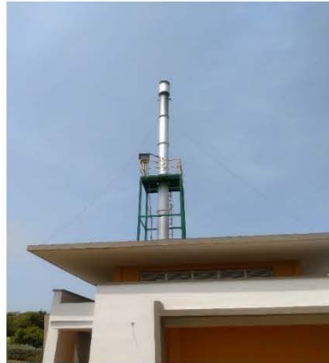
Foto 1. Chimenea del horno crematorio con su respectiva plataforma.
